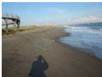
Imatge de cablejat al descobert. 28 de novembre
